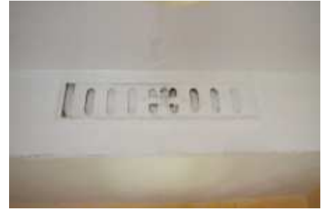
Verschiebbares Lüftungsgitter auf der Innenseite des Oberlichts, vermutlich vor einer Lufthutze. Insgesamt sind noch zwei dieser Gitter sichtbar
