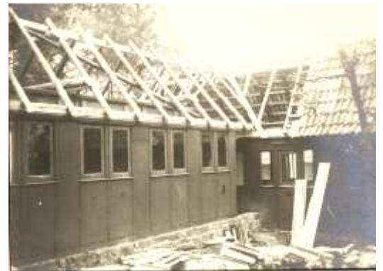
Anschluß an Waggon 3, darin eine weitere Tür sichtbar. Foto: Loheland – Archiv Nr. FB-A-712-41
