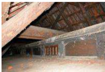
Oberlicht mit Lüftungsschlitzen ohne Hutze.
