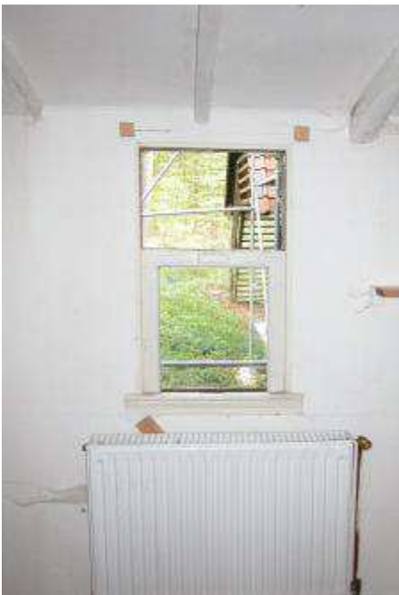
Das einzige noch schiebbare Fenster ist nicht weiter zu öffnen, da der Schacht verstopft ist.
